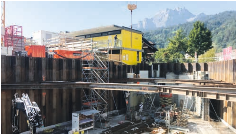
Die Energiezentrale des Seeenergie-Netzes bei den Sportanlagen Seefeld ist mehrheitlich unterirdisch.
