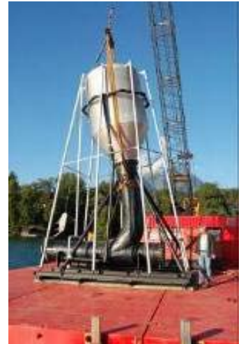
Ansaugkorb (sogenannter Seiher) der Seewasserleitung im Horwer Seebecken: 400 m vom Ufer entfernt und 40 m tief.
