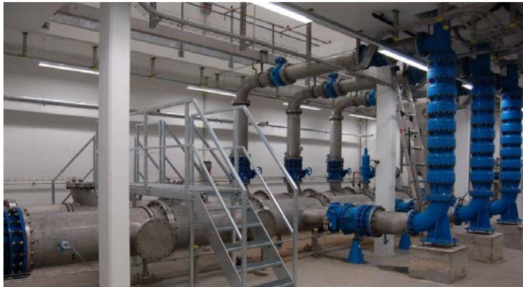
Unterirdisches Seewasserpumpwerk Krämerstein mit vertikalen Pumpen (blau)
