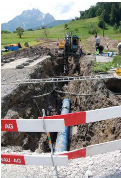
Bau der neuen Transportleitung vom Seewasserpumpwerk Krämerstein zur TWA Grämli im Bereich der Kastanienbaumstrasse
