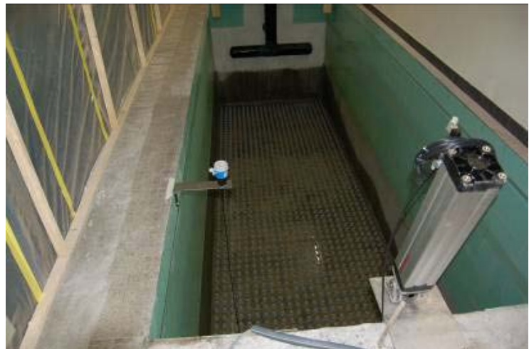
Blick in ein leeres Filterbecken auf die Bodendüsen, welches minimal saniert wurde.
