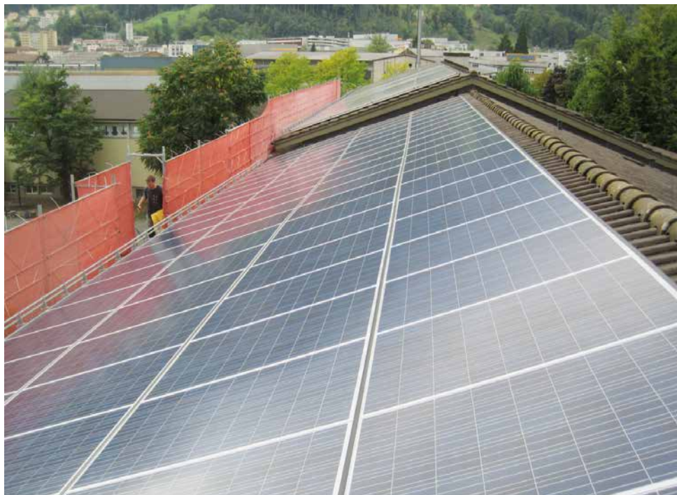
Das Potenzial des Schulhauses Allmend gemäss der Webseite Sonnendach.ch: «Eignung sehr gut». Das Allmendschulhaus verfügt seit 2010 über eine Photovoltaik-Anlage. Das Bild zeigt die dritte Erweiterung im Herbst 2014. Die insgesamt drei Anlagen produzieren zusammen rund 133'000 Kilowattstunden (kWh) Solarstrom.
