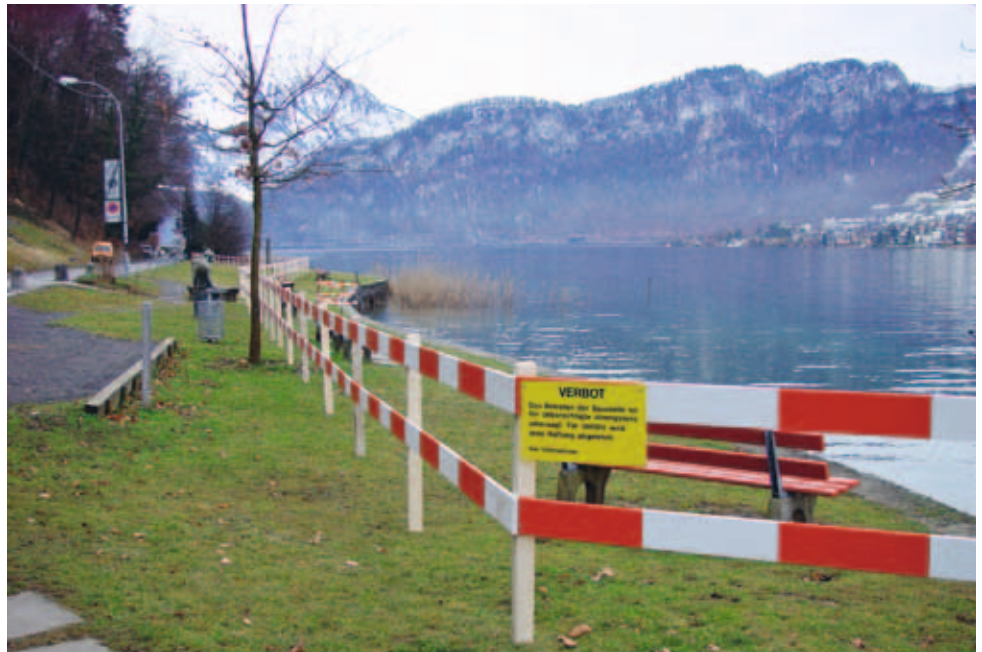
Die Rütelmauer ist stark einsturzgefährdet, weshalb sie auf einer Länge von 200 Meter abgesperrt ist.
