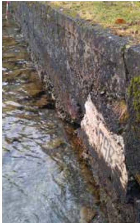
Die Mauer droht einzustürzen. Nun wird sie saniert und nach früheren Überlieferungen wiederhergestellt.
