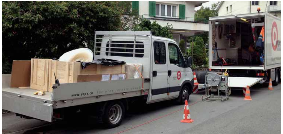
Derzeit laufen die Sanierungsarbeiten am Abschnitt 5 des Kanalsystems im Gebiet Brändi bis Steinibach.
