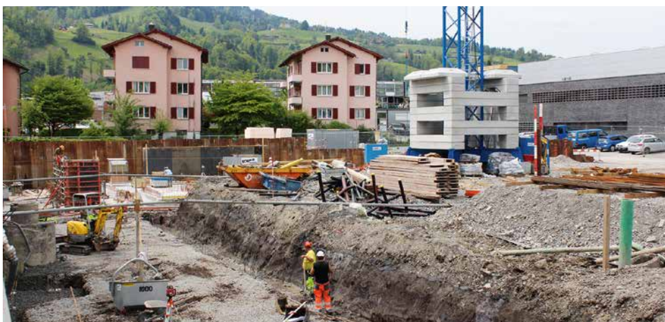
Die Arbeiten für die beiden neuen Häuser «Kopfbau Ost» und «Mittelbau» laufen auf Hochtouren.
