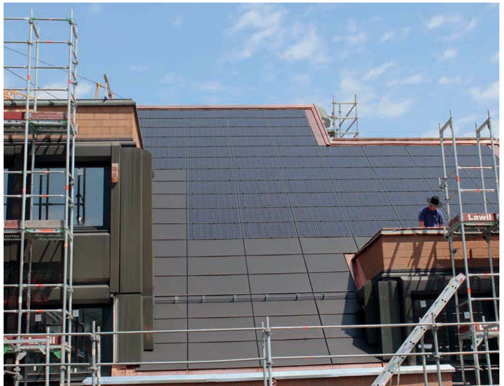
Auf dem sanierten Dach des Gemeindehauses wird derzeit eine Photovoltaik-Anlage installiert. Die Gemeinde Horw hat sich zum Ziel gesetzt, Schulhäuser, gemeindeeigene Gebäude und Verwaltungsgebäude bei einer Sanierung wenn möglich mit umweltfreundlichen Photovoltaikanlagen oder Sonnenkollektoren auszurüsten.
