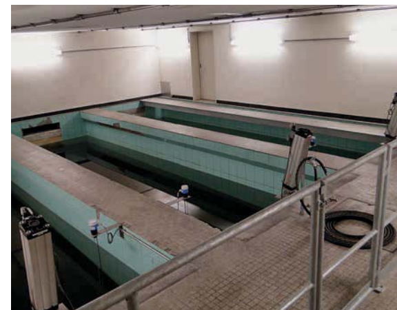
Die Filterbecken mit Aktivkohle und Sandfiltern reinigen das Seewasser.
