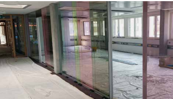
Ein Teambüro im frisch sanierten Gemeindehaus kurz vor Abschluss der Arbeiten Mitte August 2015.
