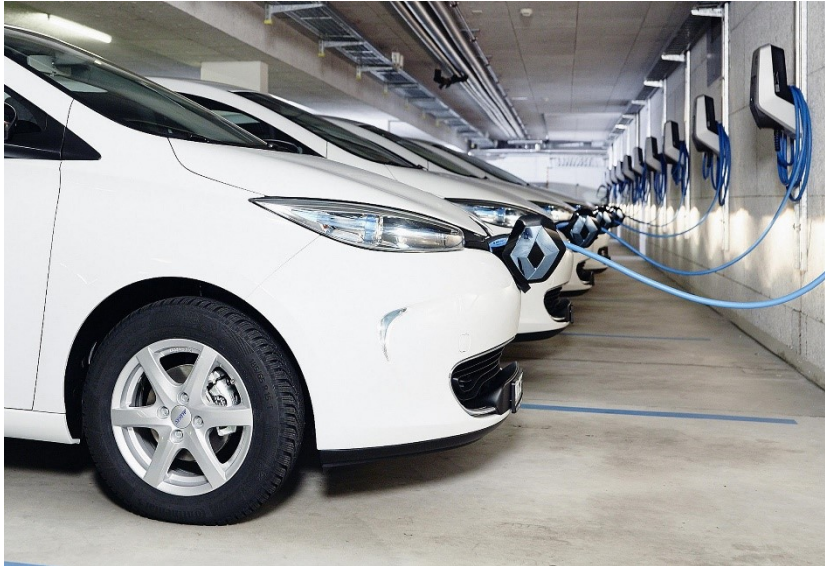
Ladevorgang bei Elektroautos (Quelle: CKW)
